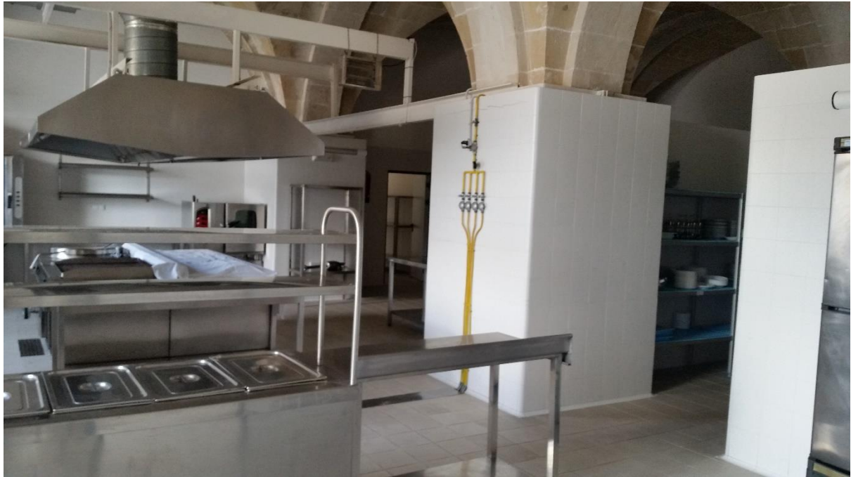
Cuina que hi ha actualment al Llatzeret. És una instal·lació de grans dimensions i ben equipada. L'inconvenient més gran, però, és el fet que es troba a l'illa del Llatzeret, al bell mig del port de Maó, el que suposa un problema logístic de transport important.
